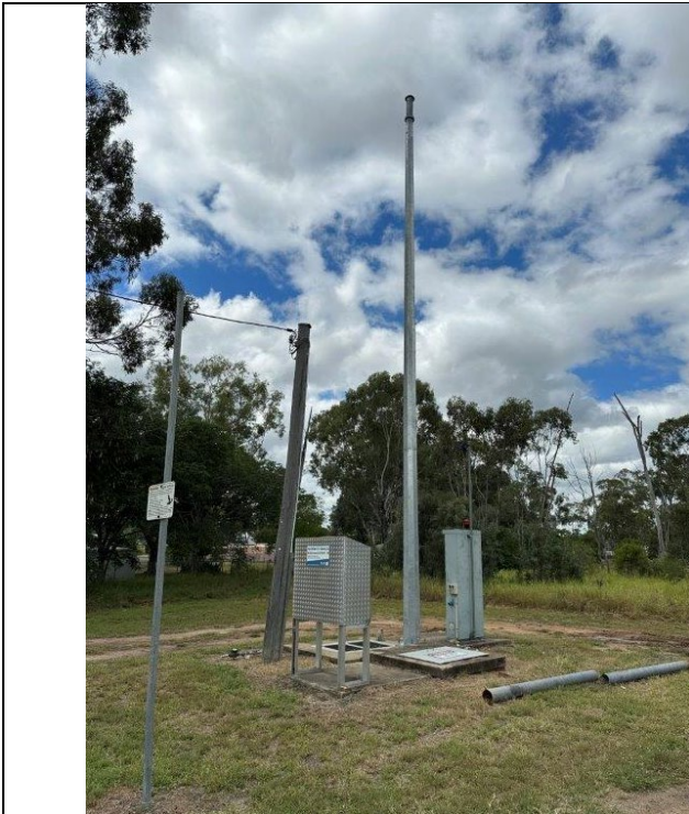
Photo 6 - SPMMT04 – 12m Vent pole
